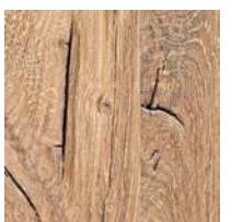
Typische Kernrisse Typical heart shakes Typische kernscheuren Fissures typiques du cœur
